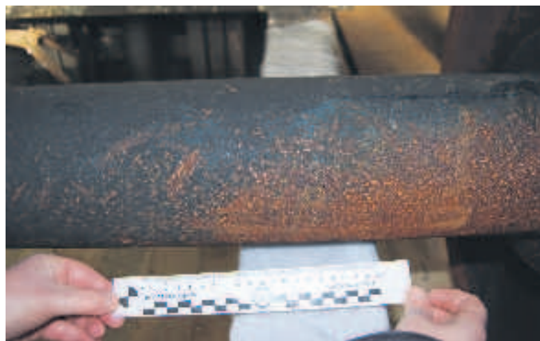
Un particolare dell'asse corrosivo
