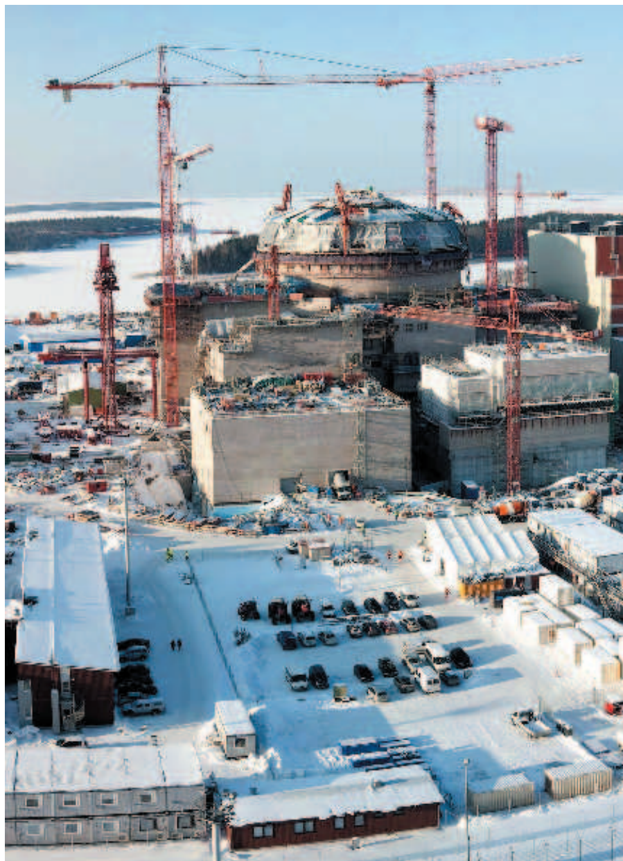
Una recente immagine della centrale di Olkiluoto 3
